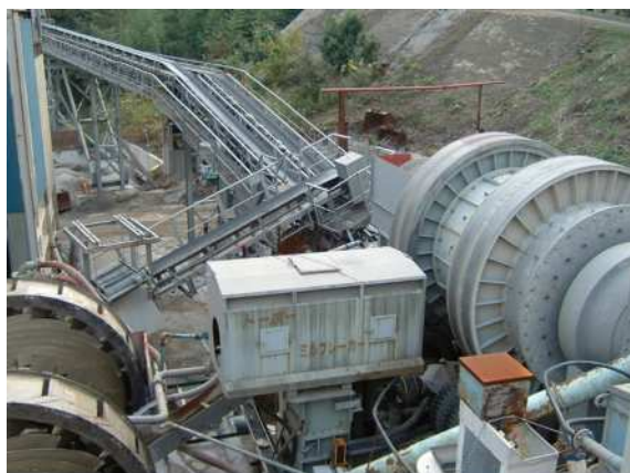
再生骨材の製造設備
